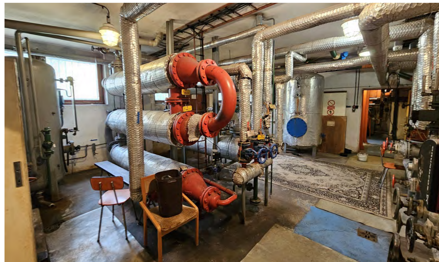
Pohled na výměňovou stanici objektu
