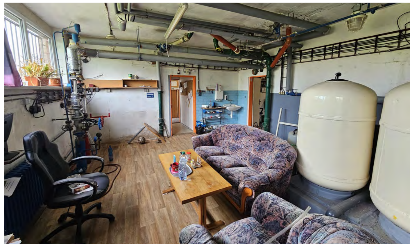
Pohled na technologii přípravy bazénové vody
