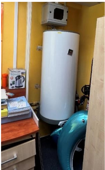
Obr. Elektrický bojler ohřevu teplé vody
