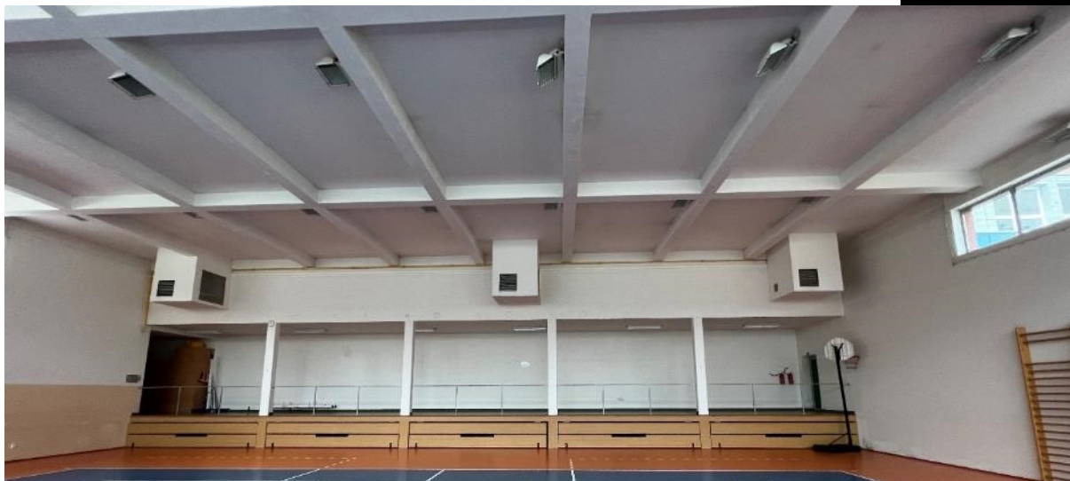
Obr. Umístění vytápěcích jednotek Sahar v tělocvičně
