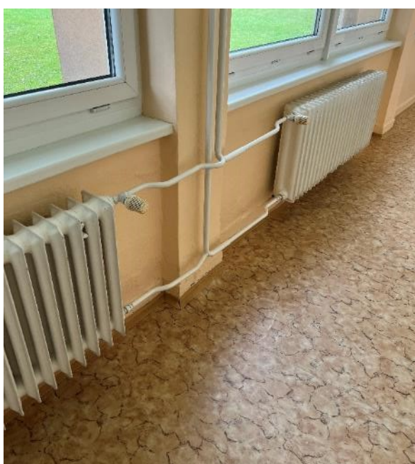
Obr. Detail OT v budově školy
