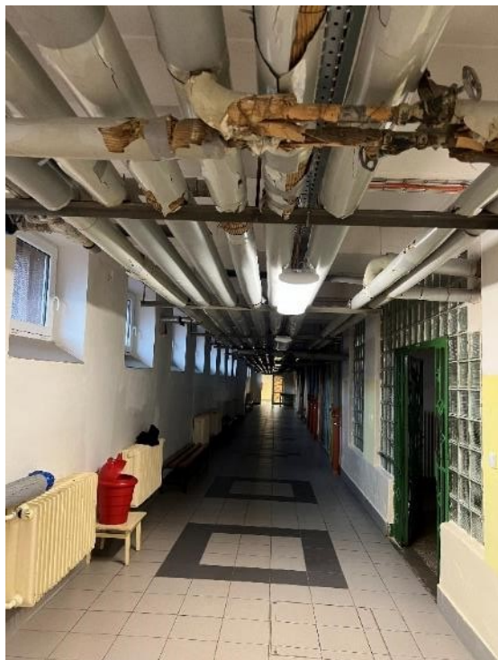
Obr. Páteří rozvody ÚT a TV
