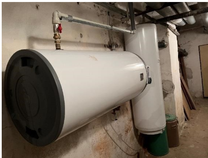
Obr. Ohřivač teplé vody
