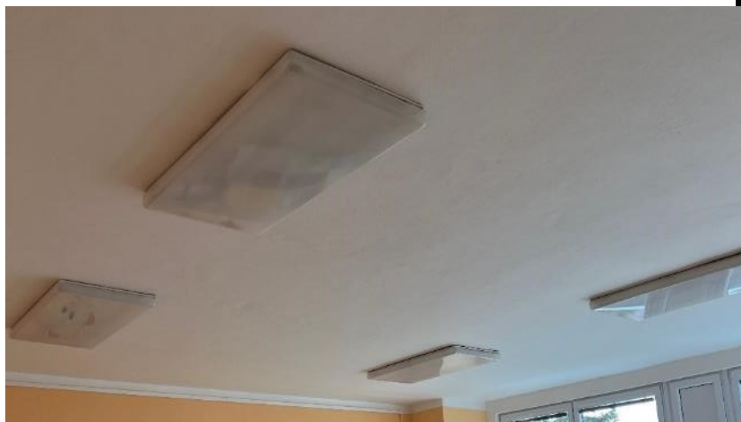
Obr. Detail osvětlení v učebně
