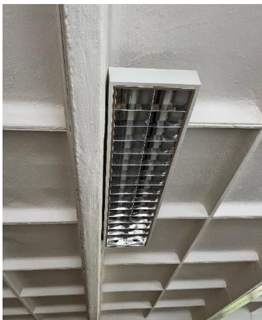
Obr. Detail osvětlení
