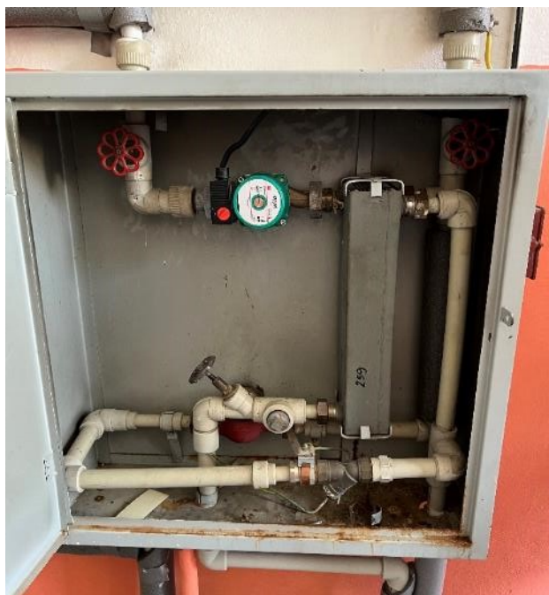
Obr. Výměník přípravy teplé vody
