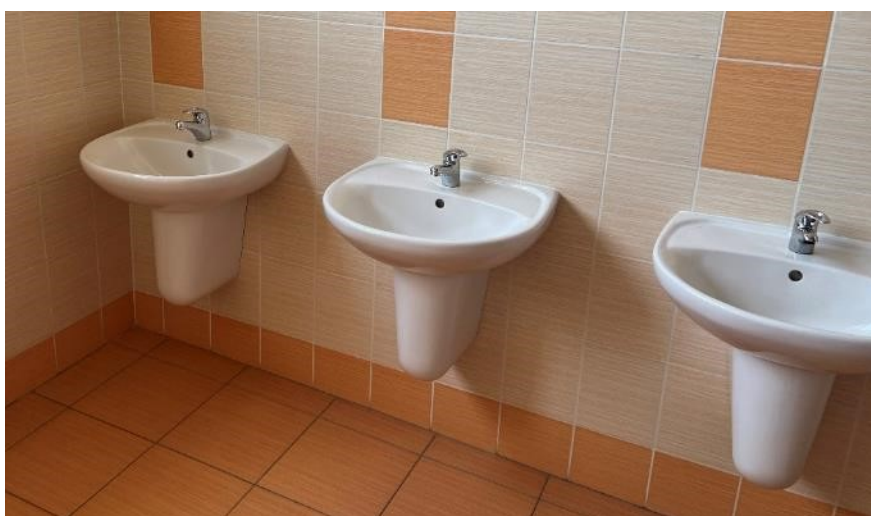
Obr. Detail výtokových armatur
