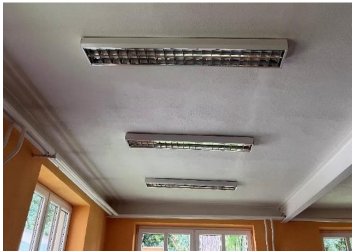
Obr. Detail osvětlení v učebně
