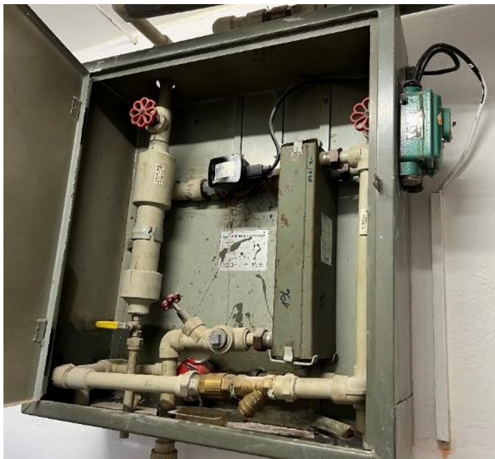
Obr. Výměňník ohřevu teplé vody
