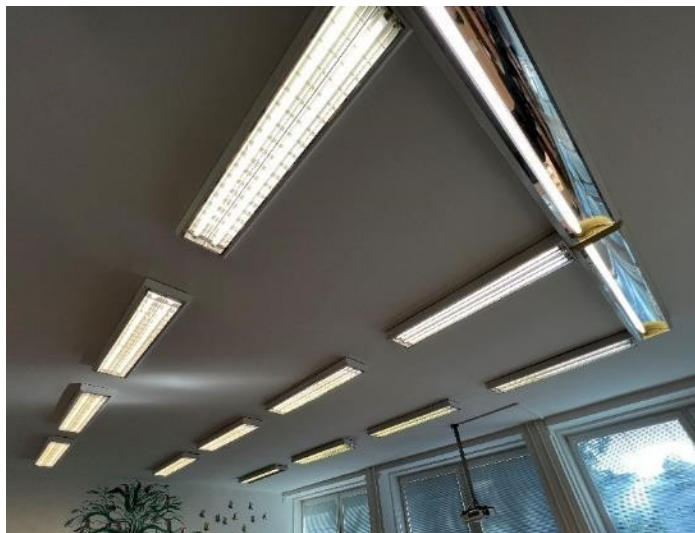
Obr. Detail osvětlení v učebně
