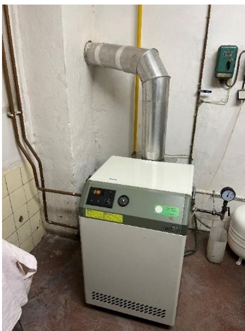
Obr. Zdroj tepla pro budovu Dílen
