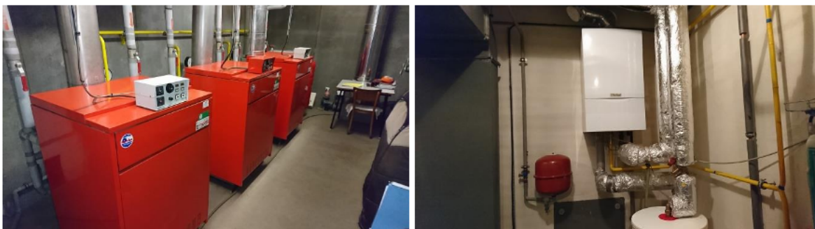
Obrázek 5: Využívané kotle pro provoz objektů (zámek + restaurace)
