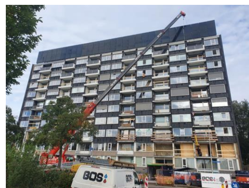
Obrázek 1.8 První dovybavená výšková budova s pozitivní energetickou bilancí v Evropě byla dokončena v Overvecht-Noord Utrecht v roce 2020.
