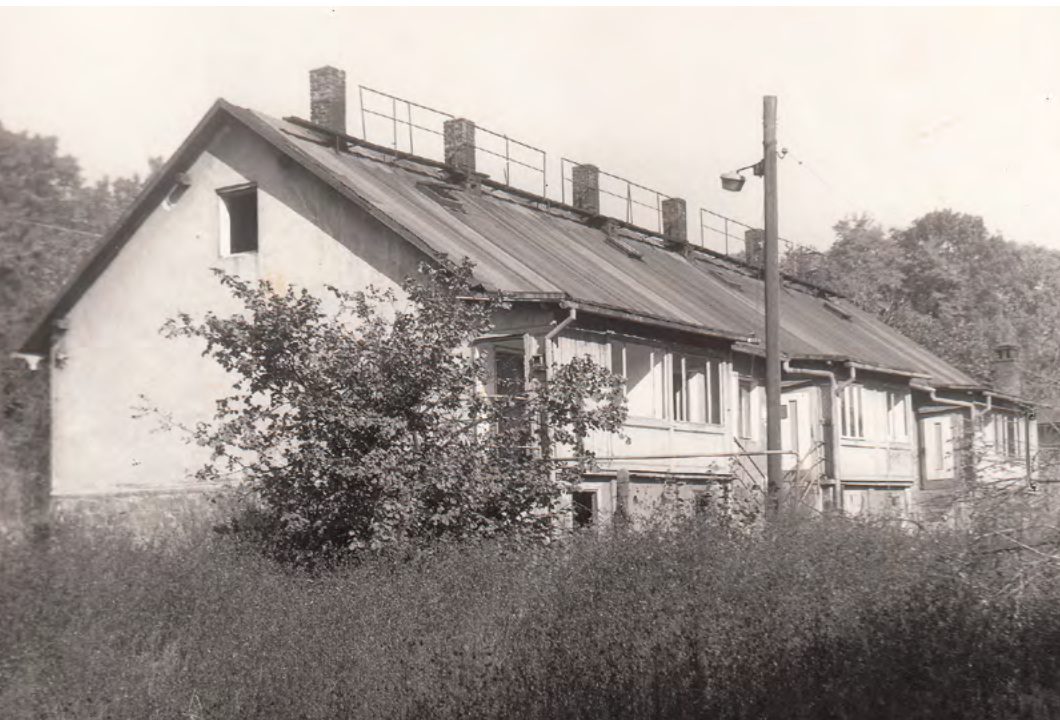
← Stav domu čp. 579 v době demoličního řízení (SOKA Karviná)
