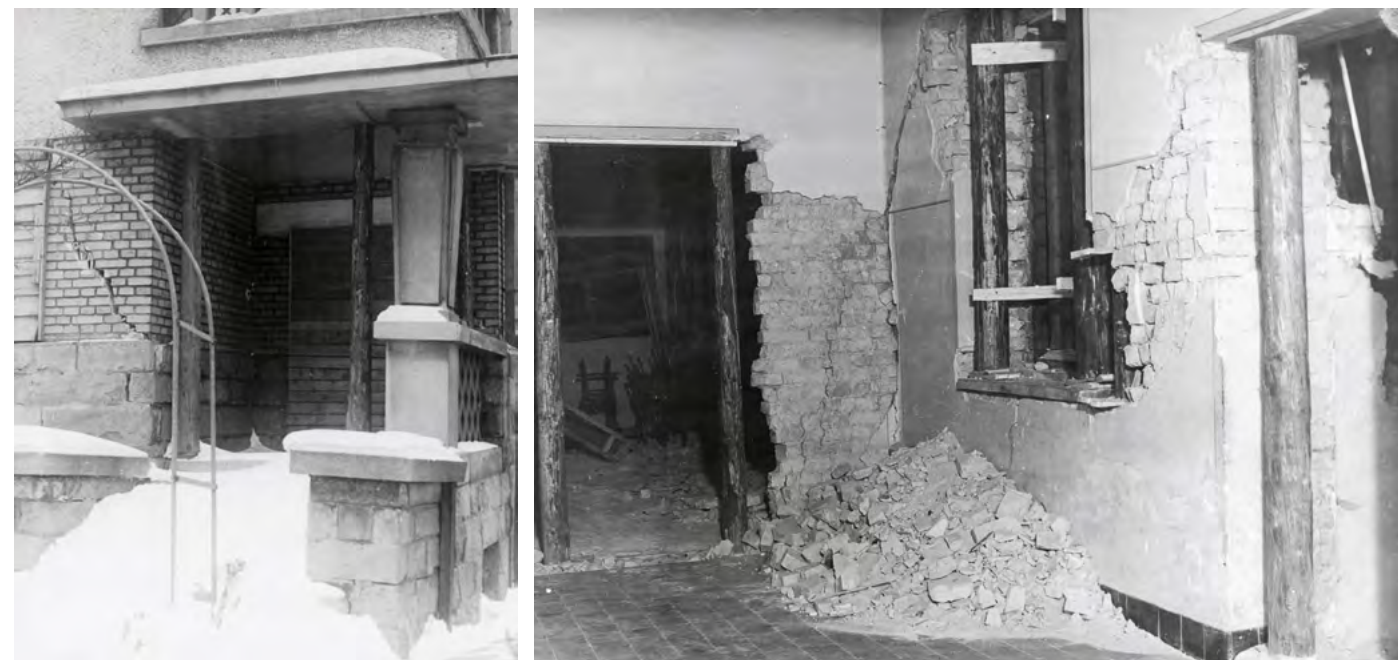
↑ Poškozené části vchodu a interiéru budovy II. české státní obecné a měštanské školy v Karviné-Dolech (Nový Jork) způsobené vlivem poddolování, fotografie z roku 1942 (SOka Karviná)
