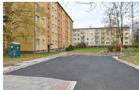
V Karviné-Ráji byla opravena parkovací „kapsa“ včetně chodníku a odvodnění. Realizaci dalších podmíňuje množství dřevin a inženýrských sítí.
