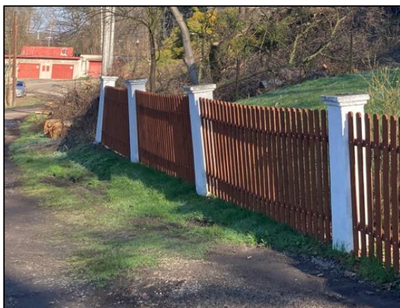
Poškození plotu na úpatí svahu ulice Kubiszova - projevy svahové nestability typu ploužení
